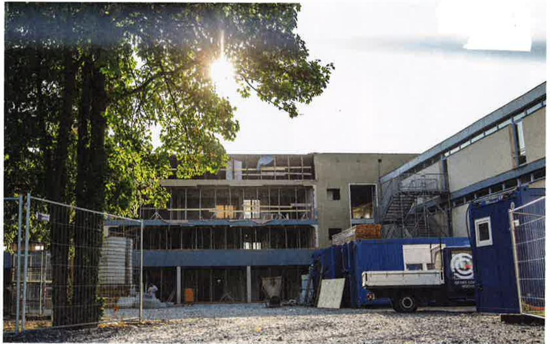
Zwischenstand der Generalsanierung des Egbert-Gymnasiums Münsterschwarzach (EMG): Trotz der sommerlichen Hitze laufen die Arbeiten wie geplant ab. Foto: Abtei Münsterschwarzach
